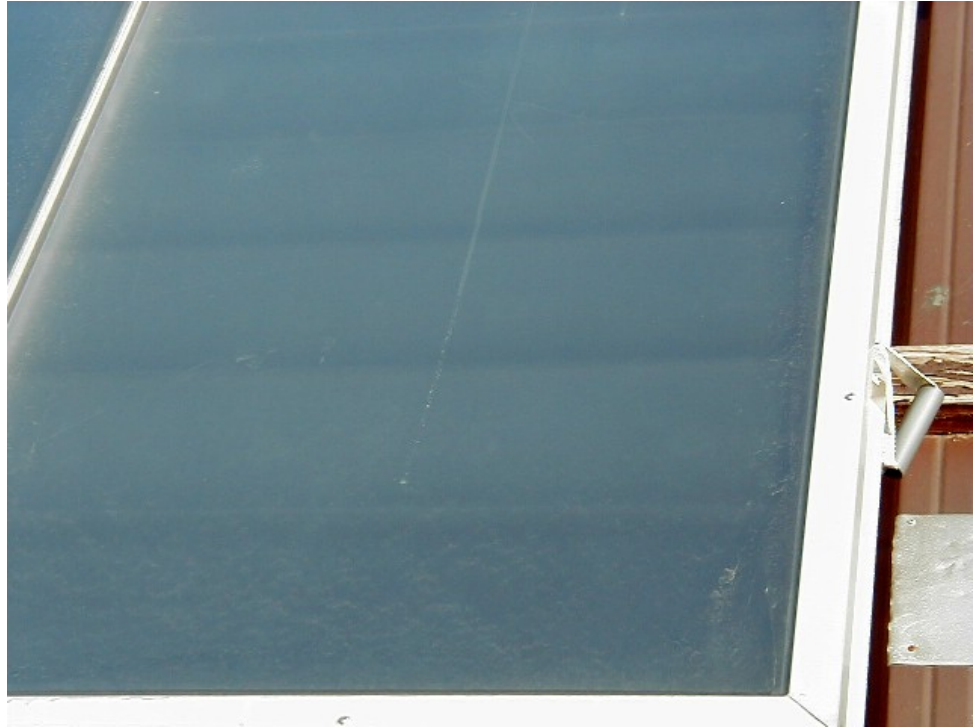
Zonnecollector onder 50 graden helling (stof stroomt ook af bij condens).
